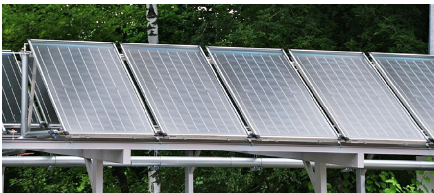
Panele instalacji solarnej zamontowane w ramach termomodernizacji
